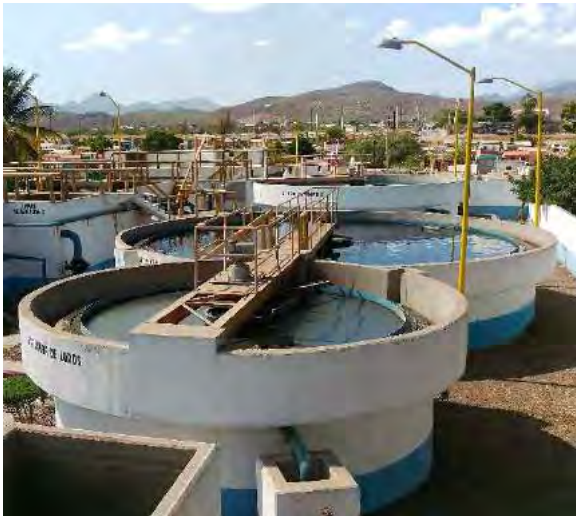
Fotografía 4. Planta de tratamiento de aguas residuales en Loreto, Mpio de Loreto, B.C.S.
